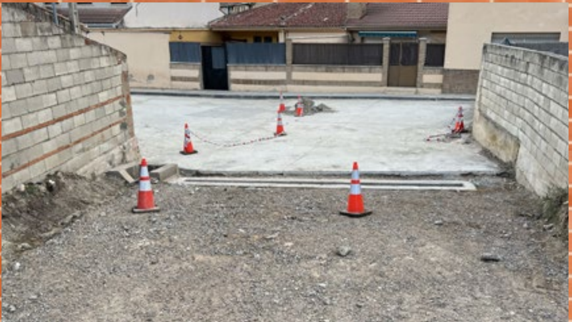
Problemas con las aguas
